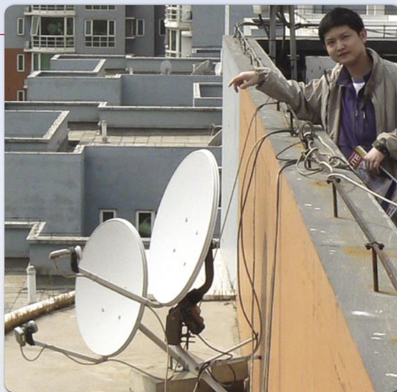
■ Alte antene sunt montate de-o parte a balustradei: o antena de 75 cm îndreptată spre 134°E și o antenă de 60 cm, motorizată cu un motor MOTECK.
